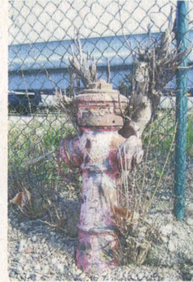
Verfallende Zeitzeugen: Ein Hydrant an der Weizenmühlenstraße.
